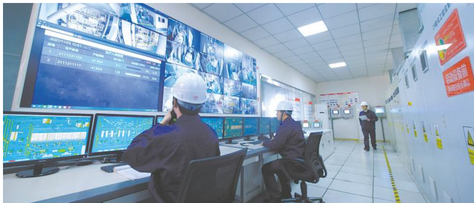
通威智能化车间中央控制室
