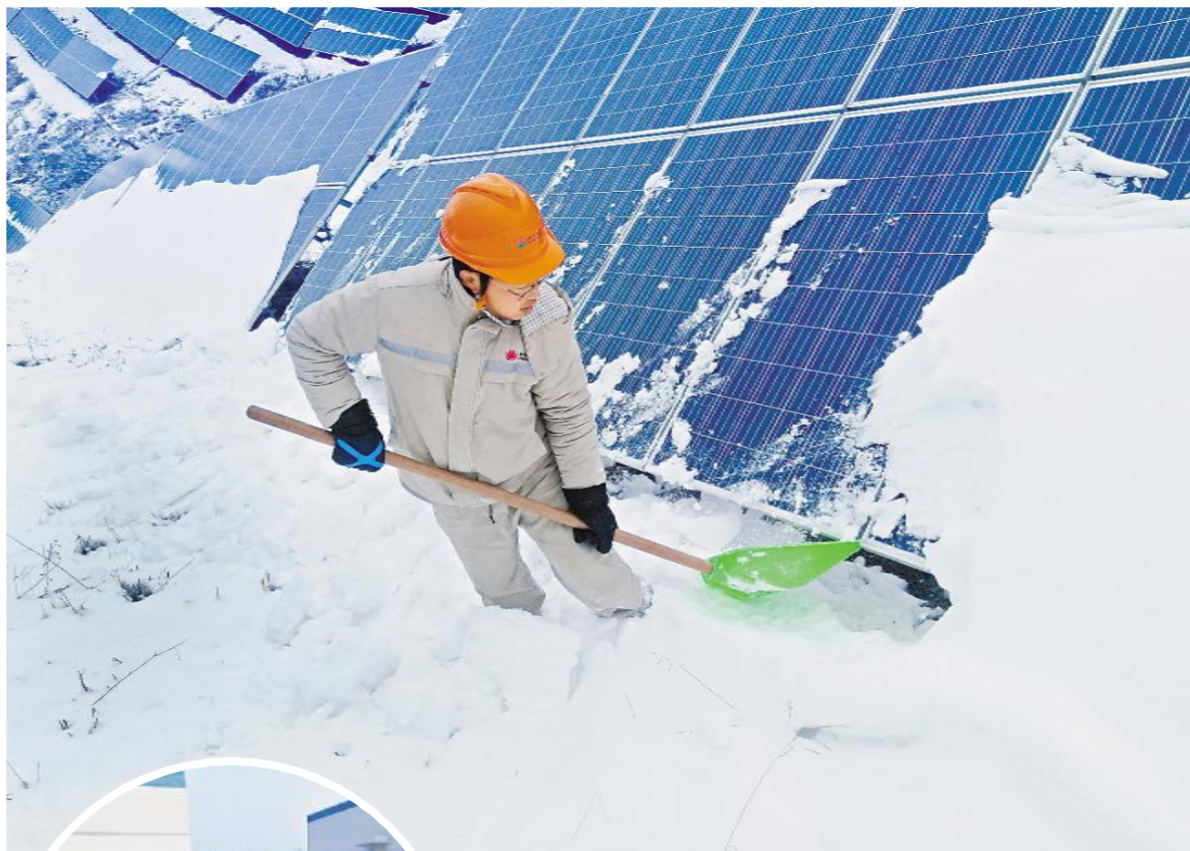
泽州电站运维人员清除光伏板积雪
