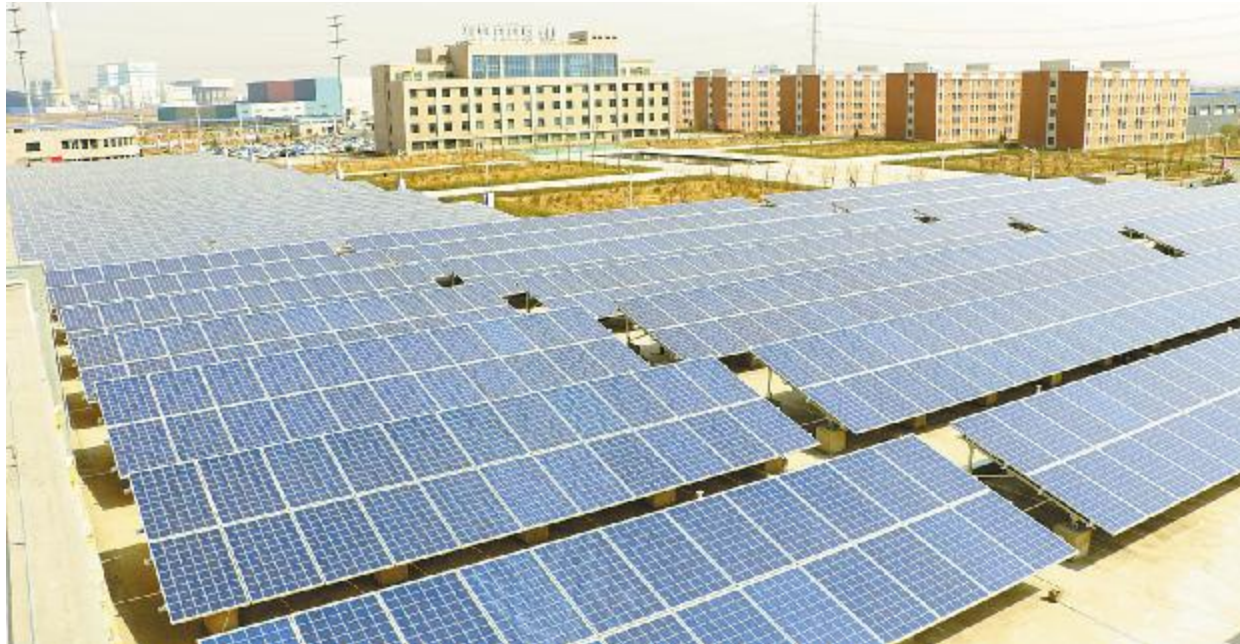
内蒙古通威高纯晶硅 2.5MW 分布式光伏发电项目正式并网
